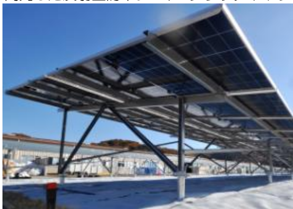
両面発電パネル下に敷設した反射防草シート「クラウディホホワイト」
